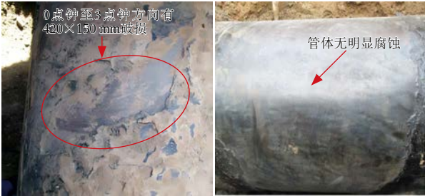
图 4 4号破损点开挖结果
