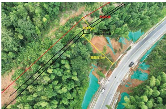
图1 公路护坡滑坡现场
