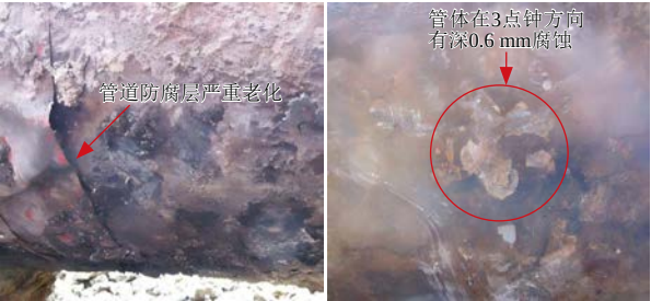
图 3 1号破损点开挖结果
