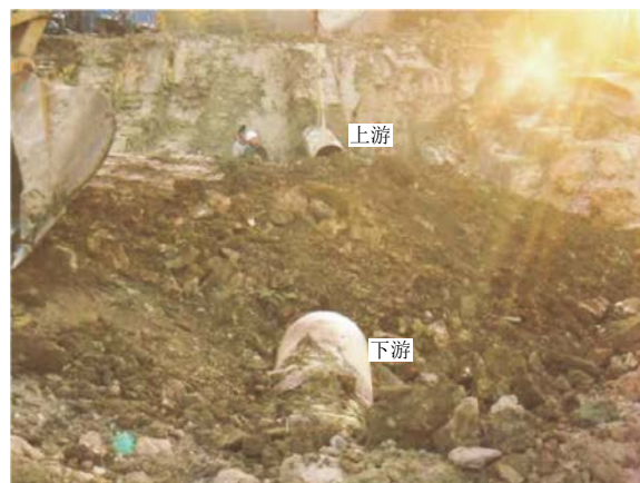
图3 管线破裂位置上下游存在偏移(此处为弯管段)
